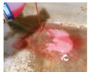
Rust stains on stones Manchas de óxido en piedras
